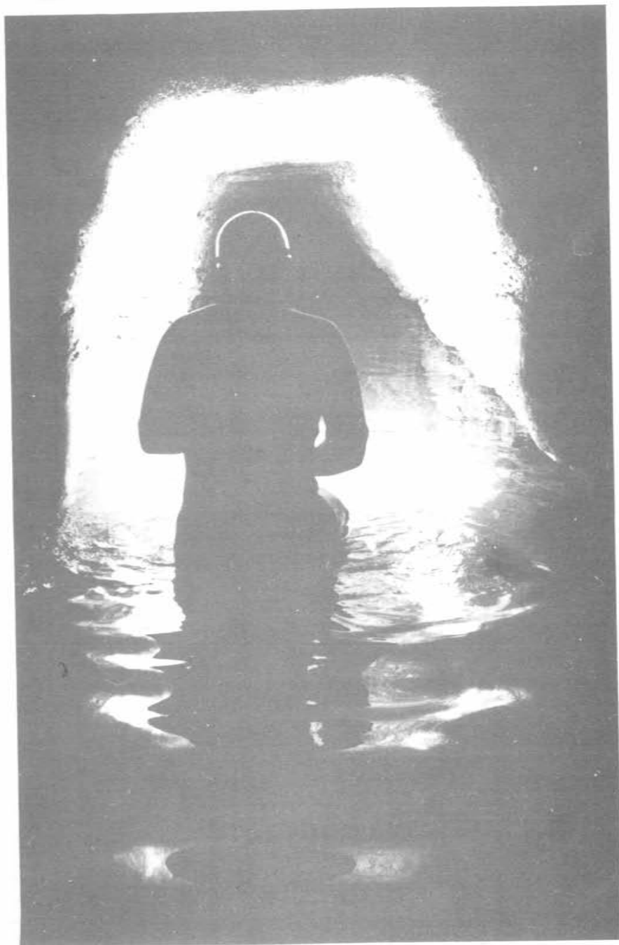
Fig. 3 A circa 50 metri da Le Mole il condotto mostra una tipica sezione trapezoidale
